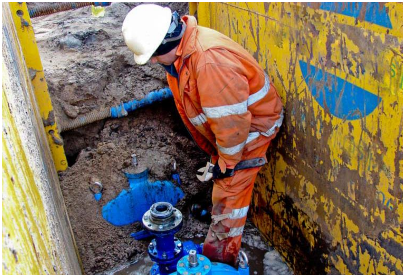
Przykład pracy w przestrzeni ograniczonej powierzchniami przewodzącymi.
